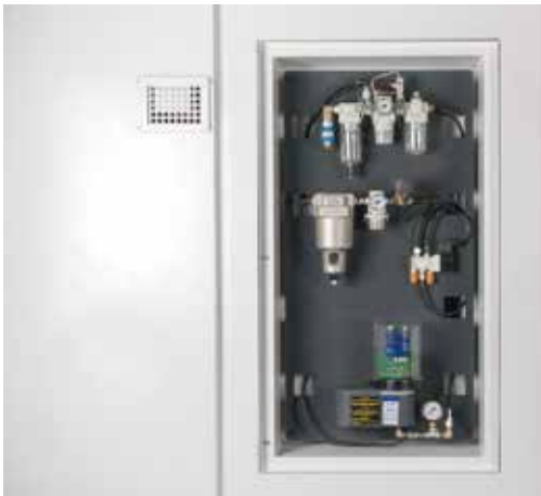
空壓電磁閥與潤滑油泵集中管理
